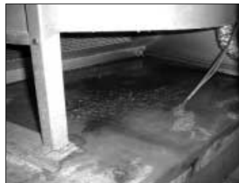
Figure 5 Eau stagnante dans une unité de ventilation
