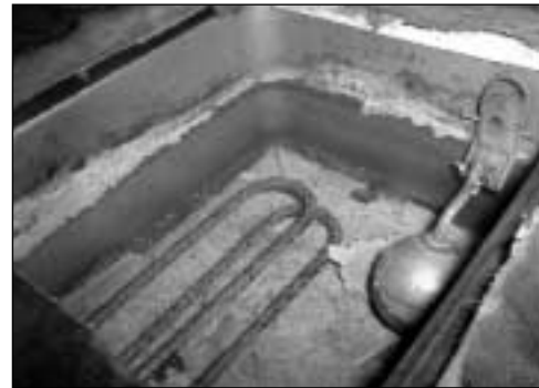
Figure 4 Réservoir d'eau d'un humidificateur en mauvaise condition
